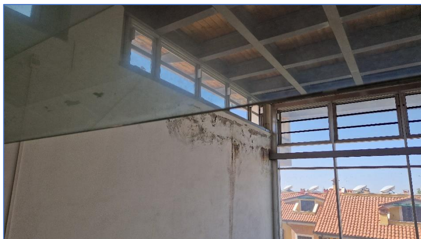
Fig. 0.1.4. – Infiltrazioni lato sud dell'atrio bioclimatico.
