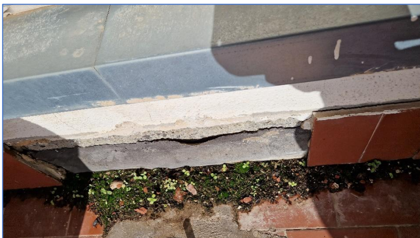
Fig. 0.2.5. – Dettaglio dell'attacco tra pavimentazione e verticale al di sotto degli infissi dell'atrio bioclimatico in opera.
